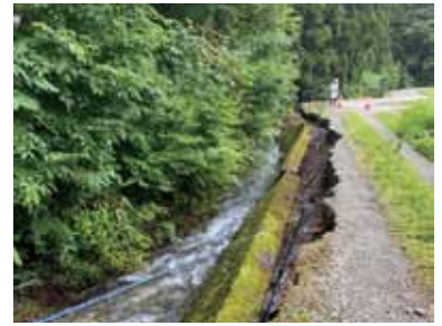
▲崩落した護岸コンクリート(早稲沢地区)
