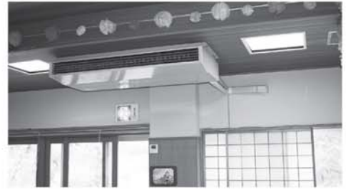
▲デイサービスセンターに冷房設備を導入
