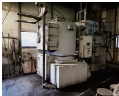
ラビスパ裏磐梯のボイラー
