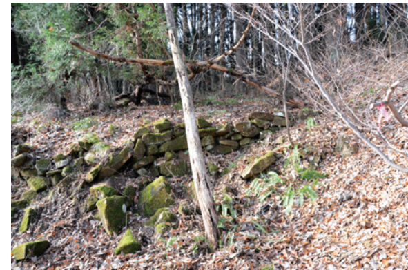
図3-25 虎口1北側の石積み 東から 茂っている樹木により崩れている部分もある。
